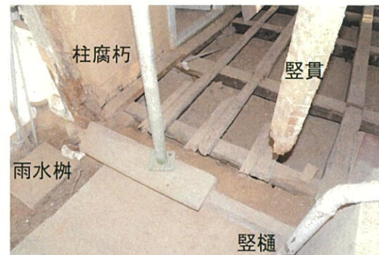
④ 応接室軸部腐朽状況
