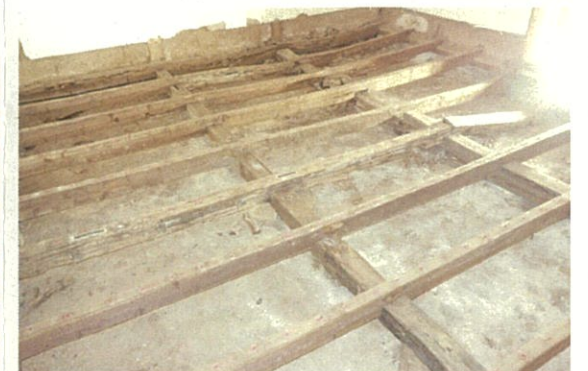
③ 使用人室 根太腐朽状況
