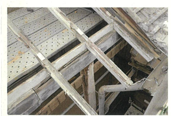
⑦ パントリー桁劣化状況
