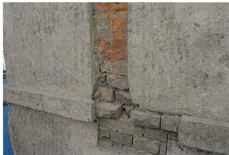
煉瓦目地劣化状況
