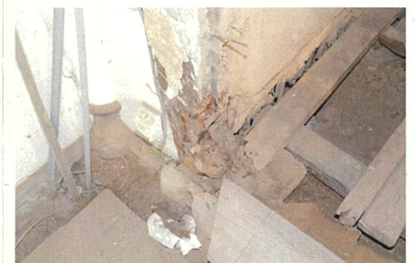
⑤ 広間応接境腐朽状況
