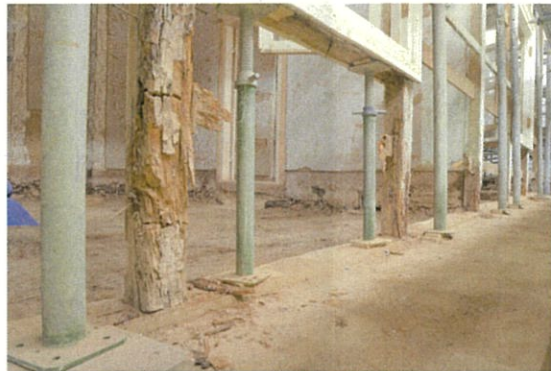
① 使用人室 柱腐朽状況
