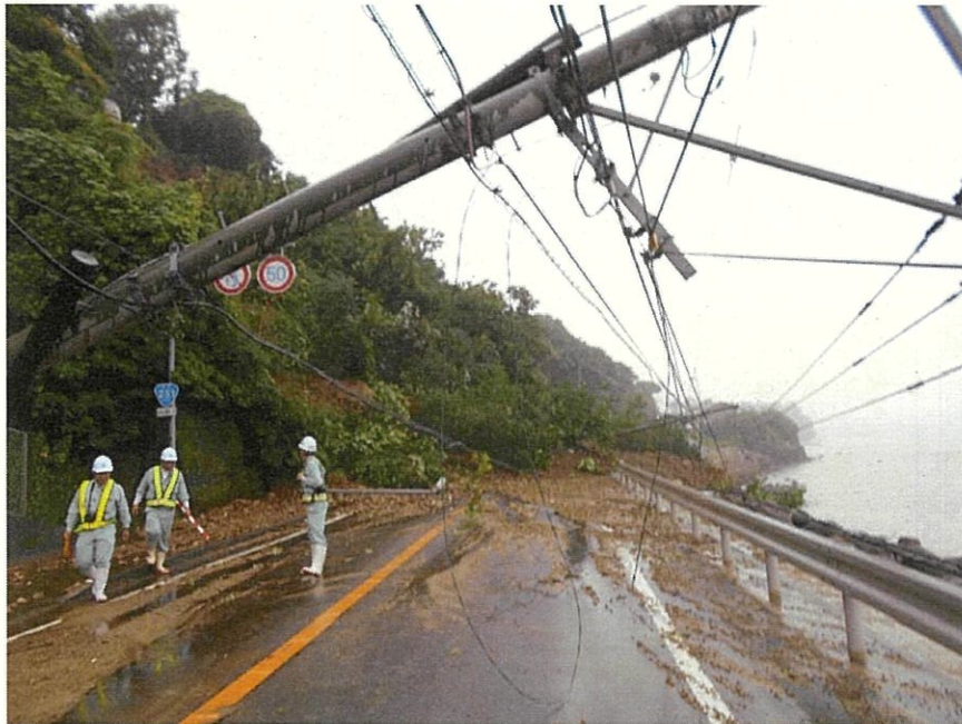
大雨による被災状況
