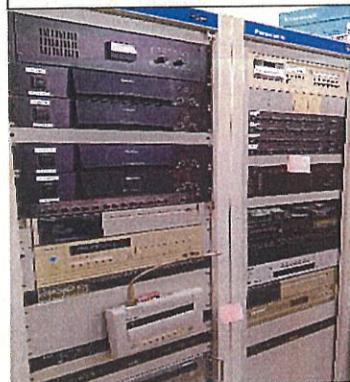
【現在】 放送設備
