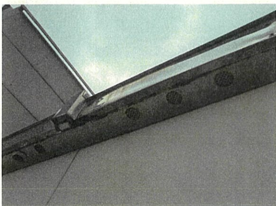
③外部腐食部分
