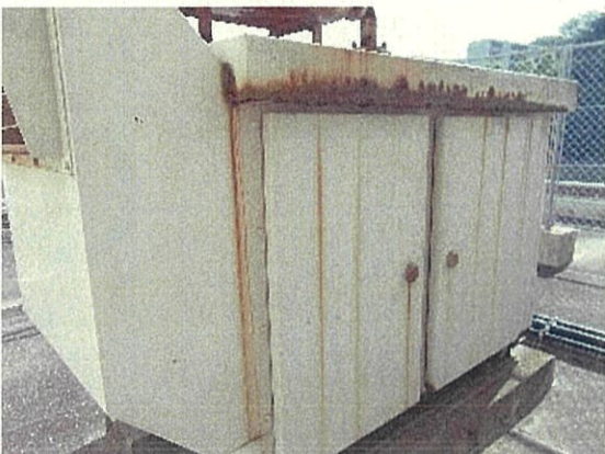
③発電機全体（裏側）
