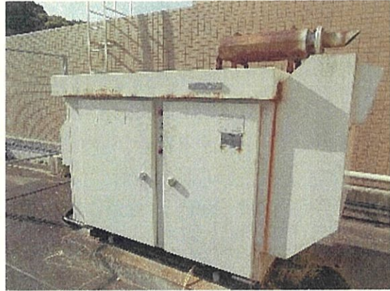
②発電機全体
