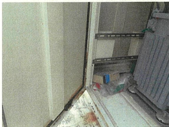
④内部腐食部分
