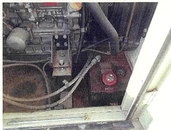
⑥腐食部分（一部）
