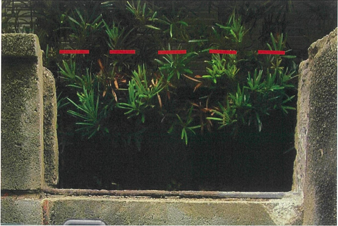
壁頂等に鉄筋が配置されていない(②の事例)
