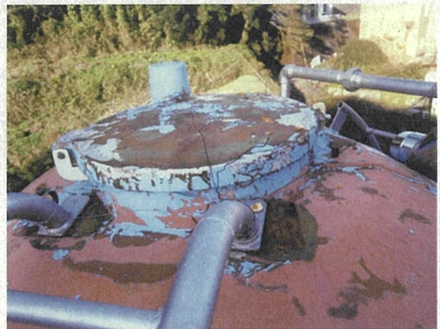
高架水槽劣化、上蓋劣化、点検用タラップの破損
