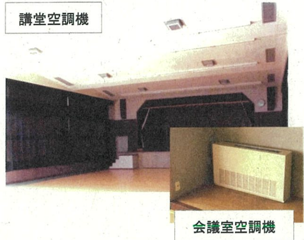
(空調室内機の状況)
