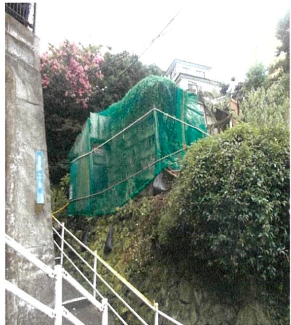
応急措置（仮設ネット）の状況
