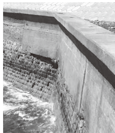
▲損壊した護岸の様子
