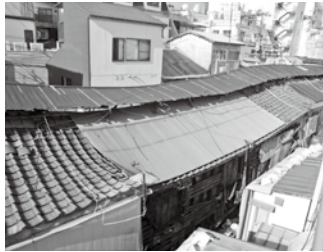
▲銅座市場の崩落現場
