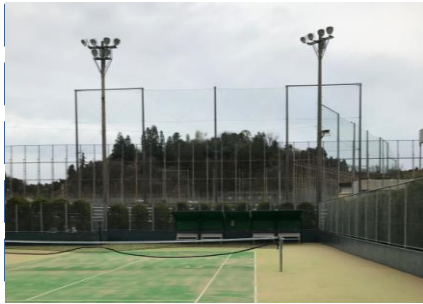
テニスコート照明設備【現状】
