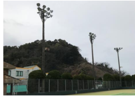
テニスコート照明設備【現状】
