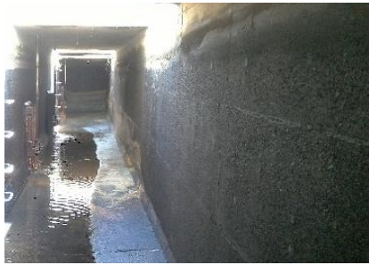
【流水等によるコンクリート劣化】
