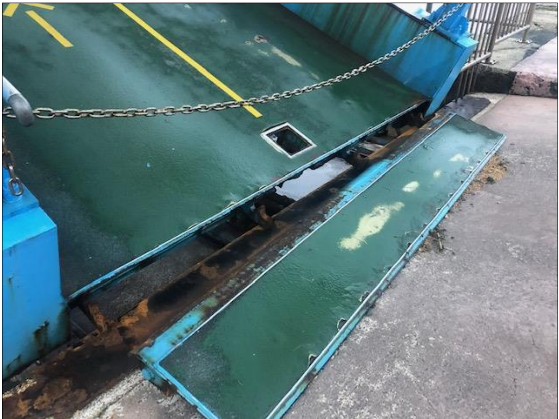
被災状況（可動橋のずれ）
