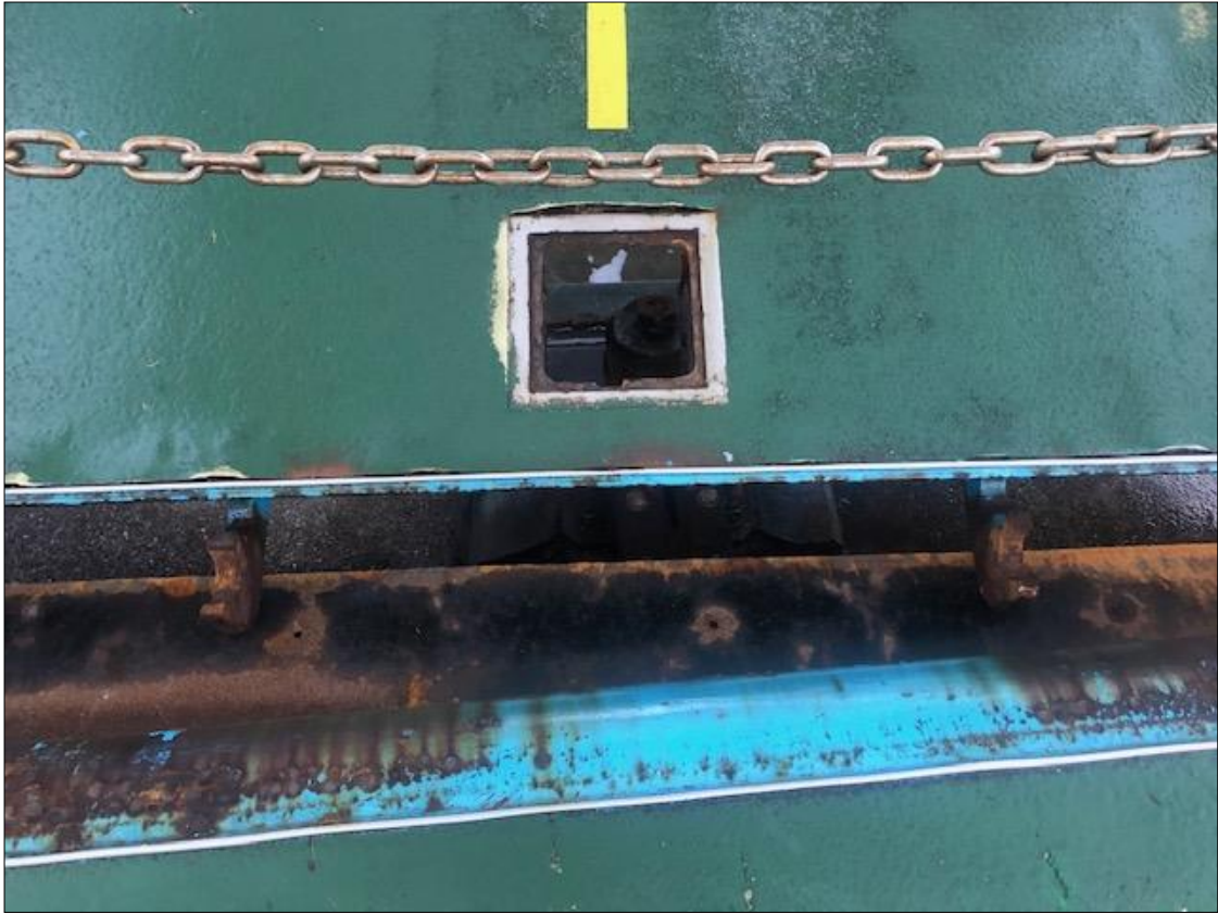
被災状況（可動橋のずれ）
