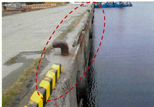
岸壁改良：防舷材の欠落、コーナープレート・車止めの破損
