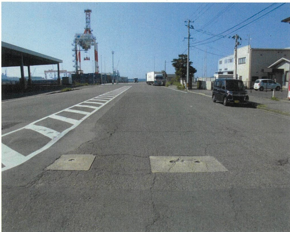
道路改良:舗装のクラック状況
