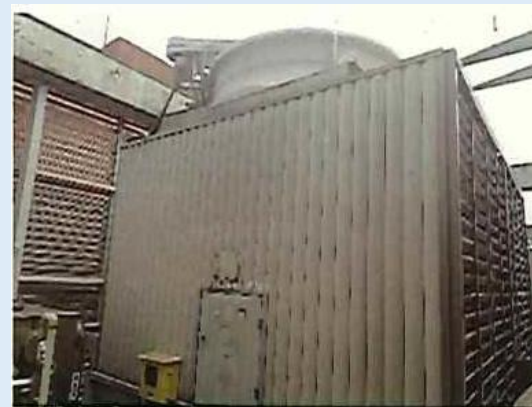
【吸収冷暖房機用冷却塔】
