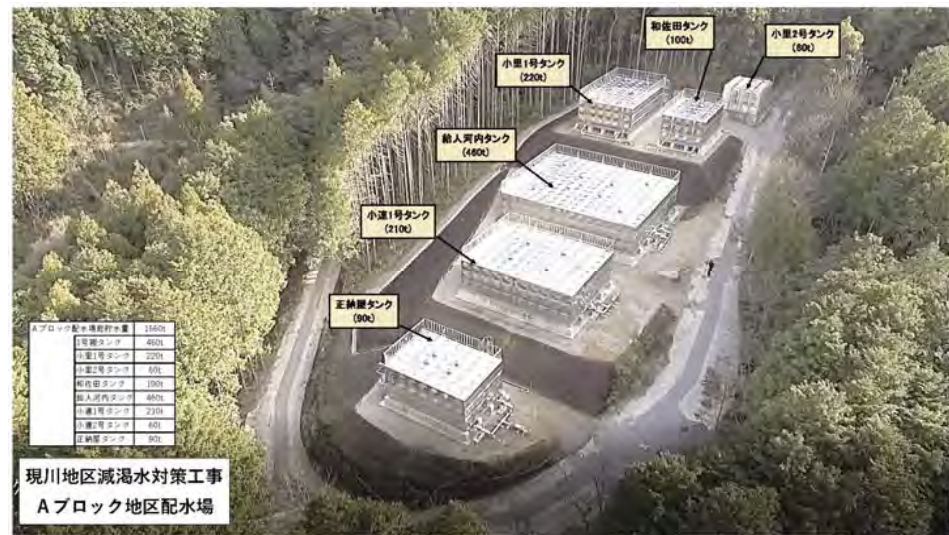
受水タンク〔現川Aブロック〕
