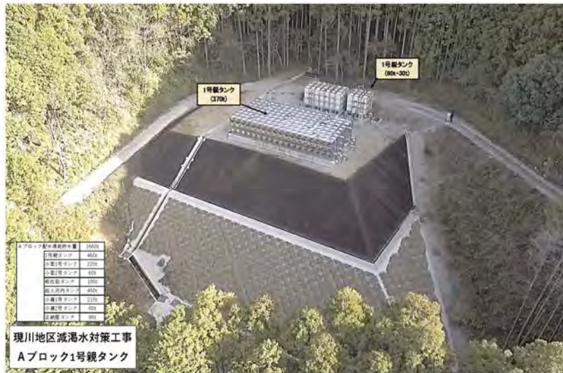
貯水タンク〔現川Aブロック〕
