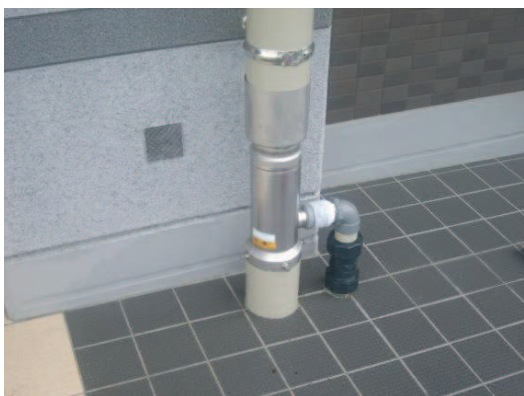
雨水集水装置
