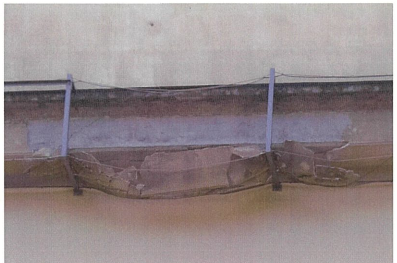
剥落箇所拡大
