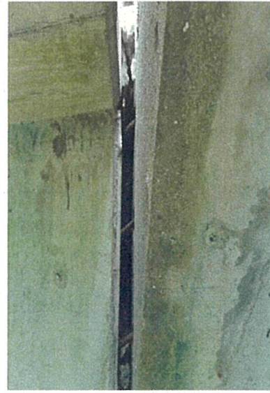
擁壁と擁壁の隙間
