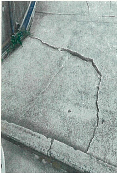
土間コンクリート沈下
