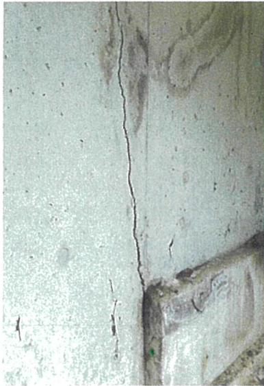
擁壁縦にクラック
