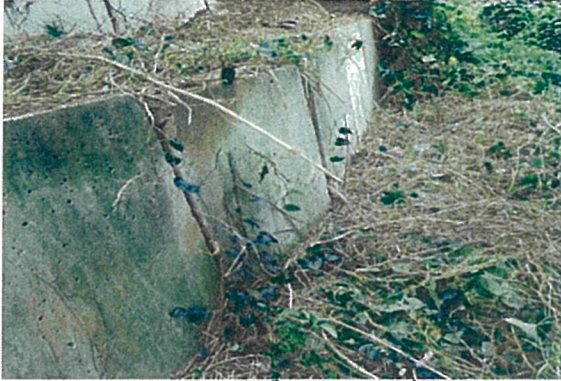
土留めコンクリートブロックのズレ
