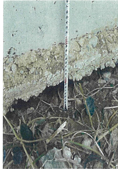
擁壁基礎地盤沈下
